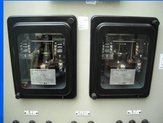
過電流継電器(高圧のショート検出)
