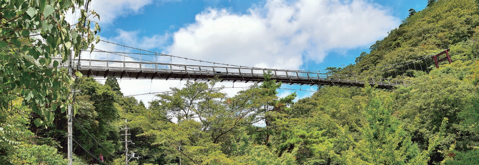
大江山の二瀬川溪流にかかる吊り橋の新童子橋。現在通行止め(解除時期は未定)
