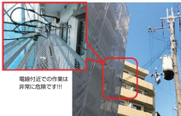
図1 仮設の足場に接触した低圧引込線
