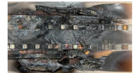
写真4 焼損箇所の様子
