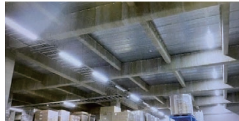
写真1 大規模物流倉庫に設置されたLED照明
