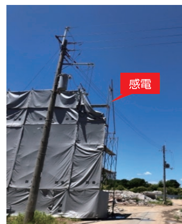
図2 解体作業中の感電
