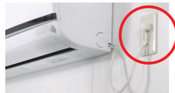
エアコン専用コンセントを確認
