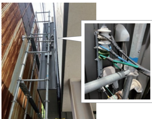
事例2 引込線に接触した足場
